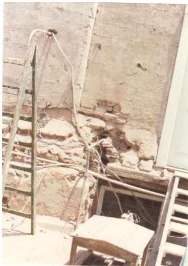
Segunda planta del Museo antes de su restauración. Ver detalle de las instalaciones eléctricas
