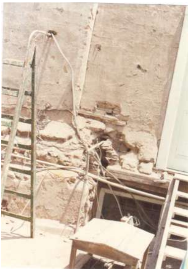
Segunda planta del Museo antes de su restauración. Ver detalle de las instalaciones eléctricas
