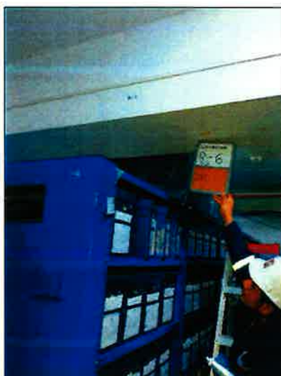
Vista de Esclerometría Punto S2-R6. Base viga
