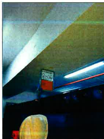
Vista de Esclerometría Punto S1-R6. Base Viga
