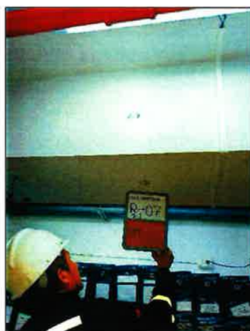
Vista de Esclerometría Punto S1-R7. Base Viga
