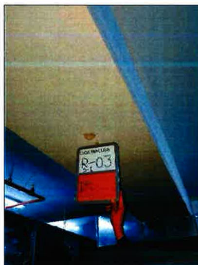
Vista de Esclerometría Punto S1-R3. Base Viga
