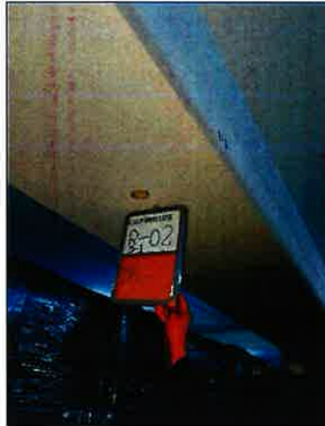
Vista de Esclerometría Punto S1-R2. Base Viga
