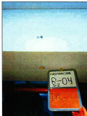
Vista de Esclerometría Punto S2-R4. Base viga
