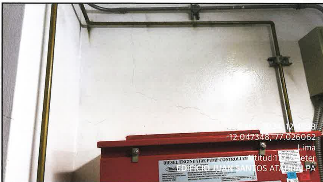
Ilustración 9: Se observa en la imagen un agrietamiento superficial del muro, sin evidencia de un daño significativo hacia el edificio,
