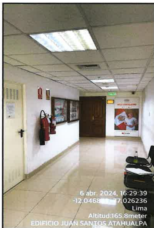
Ilustración 11: En la imagen se pueden observar las baldosas y el falso techo suspendido, también conocido como cielo raso, que están instalados en los techos de cada nivel de la edificación
