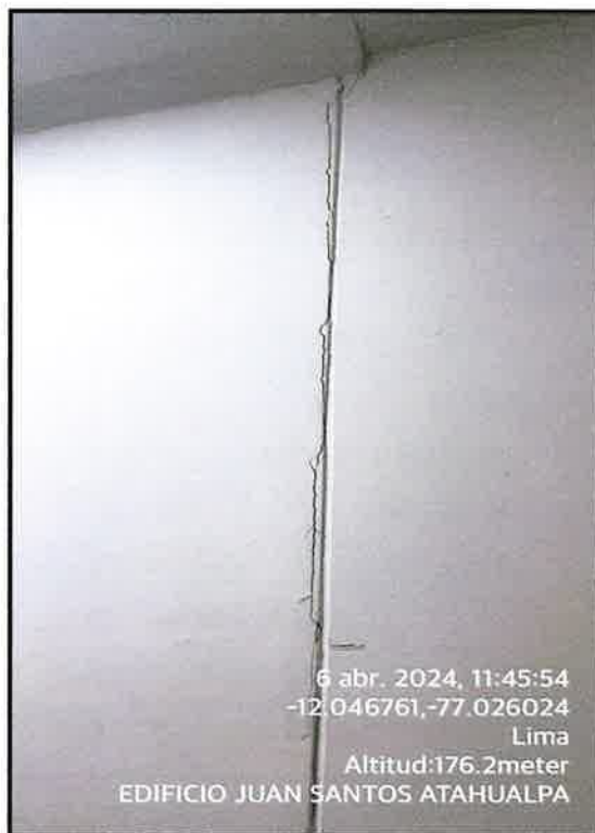
Ilustración 5: En la imagen de aprecia En la imagen adjunta se observa una pequeña fisura ubicada justo al lado de la junta. Esta fisura parece ser de naturaleza superficial, es decir, afecta únicamente la apariencia externa sin penetrar profundamente en la estructura.
