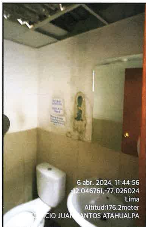
Ilustración 4: Se constata presencia de humedad en servicios higiénicos del edificio
