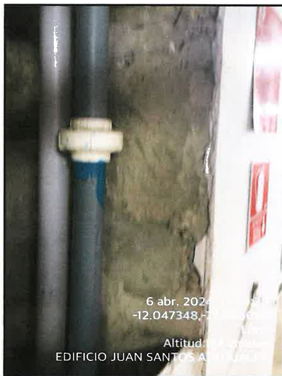
Ilustración 7: En la imagen se observa que hay tuberías que no están cubiertas de manera técnica, lo que significa que están expuestas en parte de los ductos de la edificación
