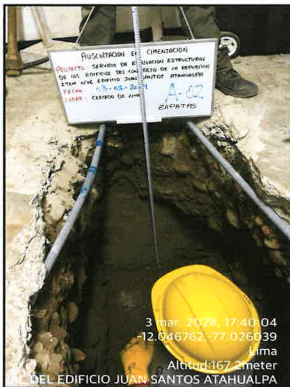
Ilustración 17: Durante el proceso de auscultación de la zapata A-02, se ha identificado la presencia de tuberías de instalaciones durante la excavación.
