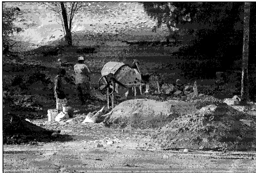
Construcciones ilegales en las faldas de las dunas de la Laguna de la Huacachina. 7 de setiembre 2011
