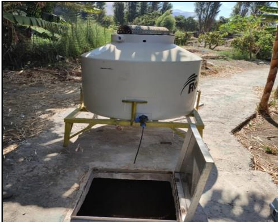
Fotografía 7: sistema de desinfección en cámara de reunión
