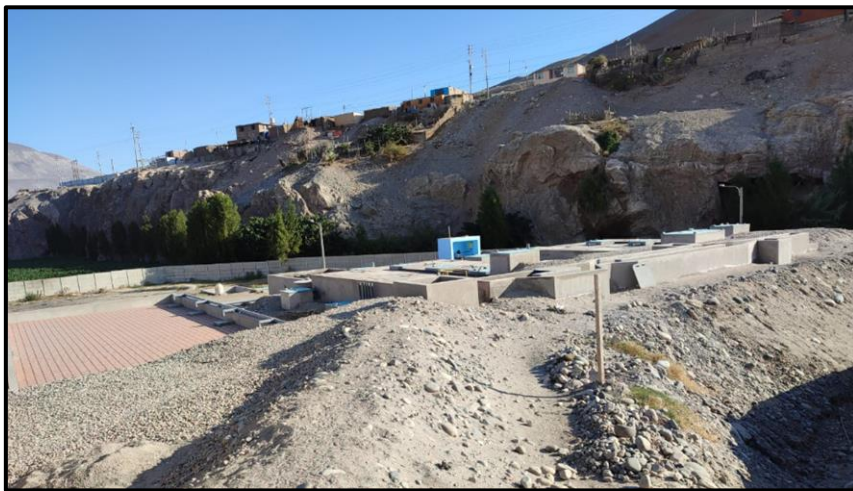
Fotografía 5: PTAR De la Municipalidad distrital de Uraca
