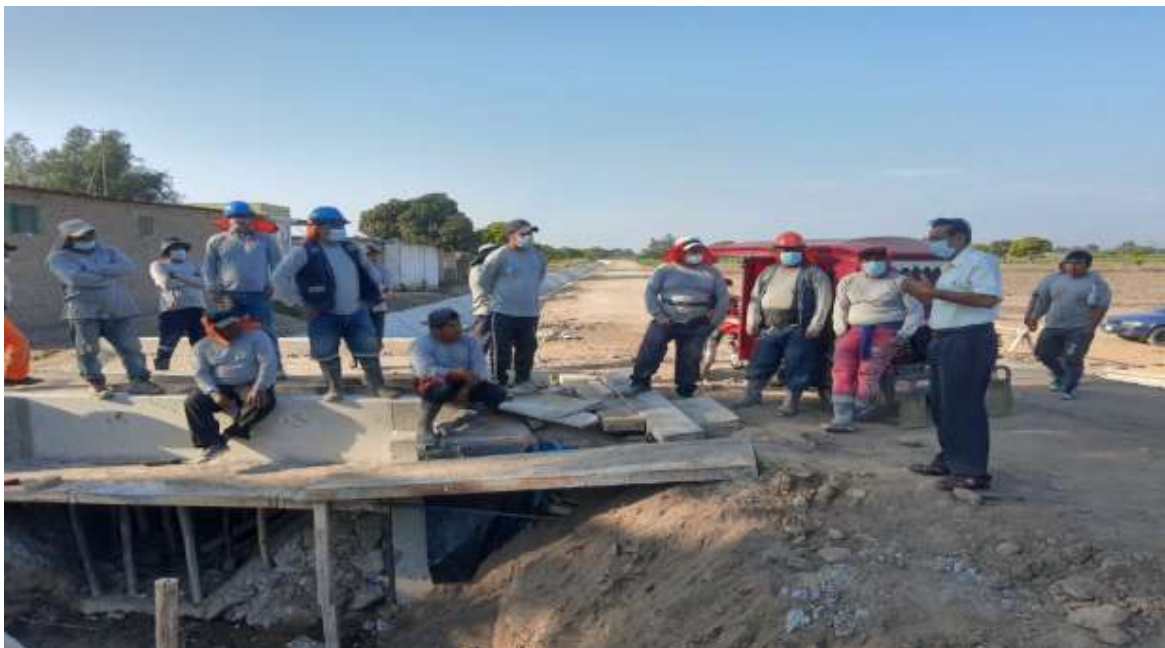
Conversando con los trabajadores con la finalidad de promover mayor celeridad en la ejecución de la obra a pedido de los regantes
