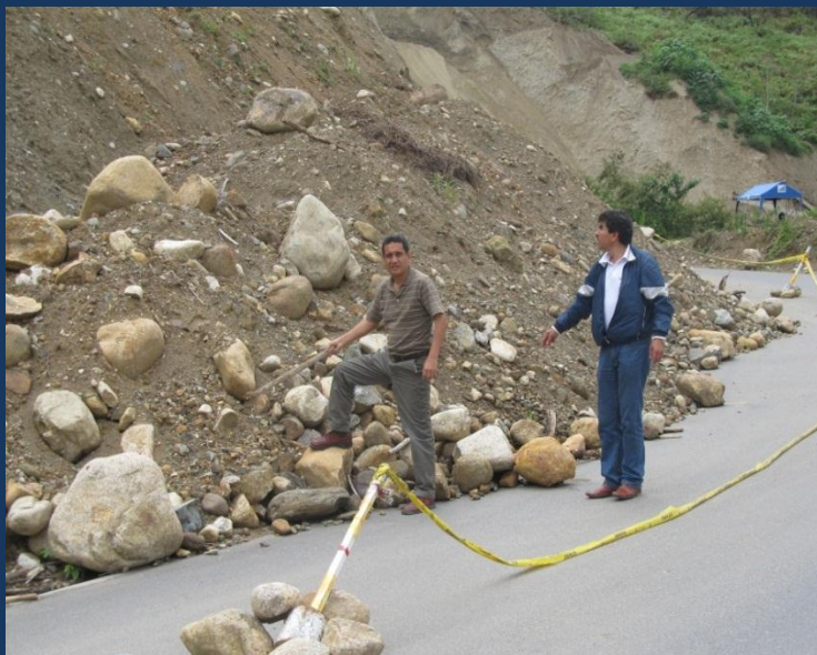
Supervisión de la nueva carretera de San Ignacio a Namballe (distrito fronterizo del Ecuador). Se evidencia presencia de derrumbes que obstaculizan la vía principal.
