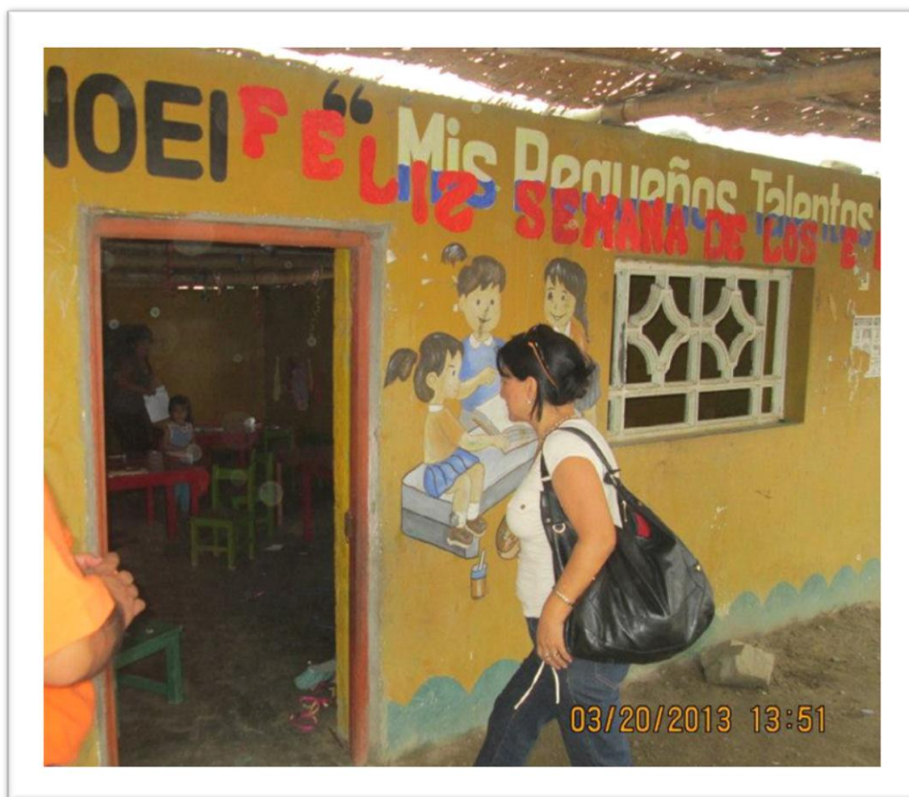
FACHADA DEL PRONEI “MIS PEQUEÑOS TALENTOS”. LA INFRAESTRUCTURA DEL COLEGIO, COMO PUEDE OBSERVARSE, ES MUY PRECARIA
