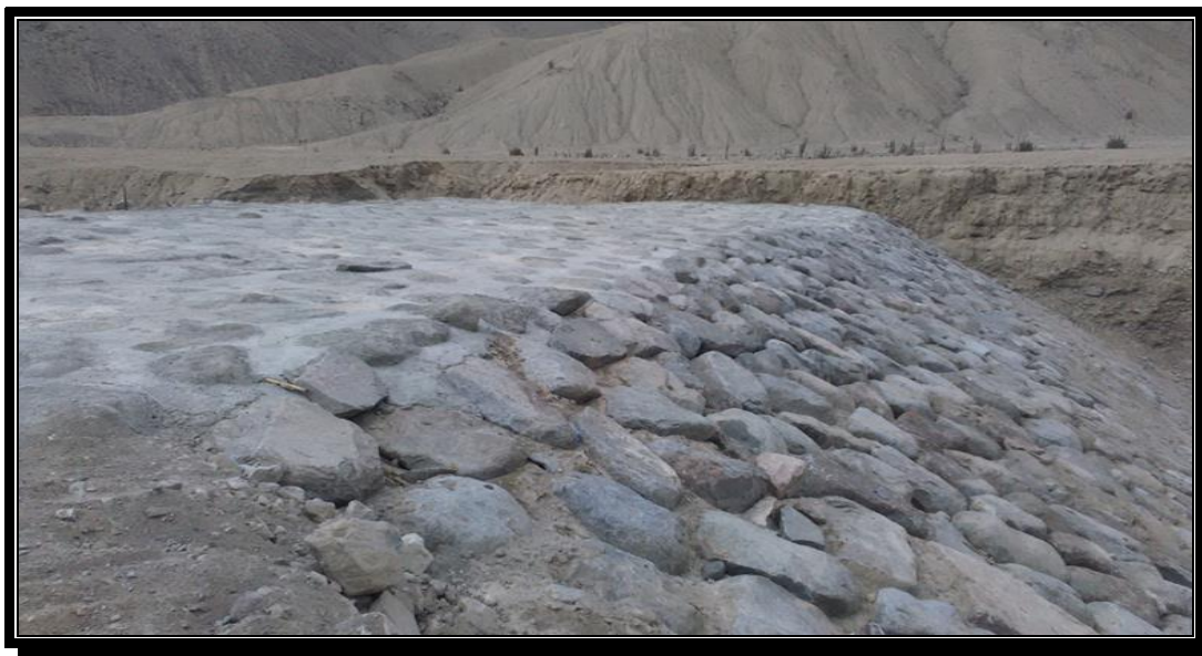
UNO DE LOS 6 DIQUES COSTRUIDOS EN LA QUEBRADA LA YASERA – DISTRITO DE SAN JOSE DE LOS MOLINOS – ICA.
