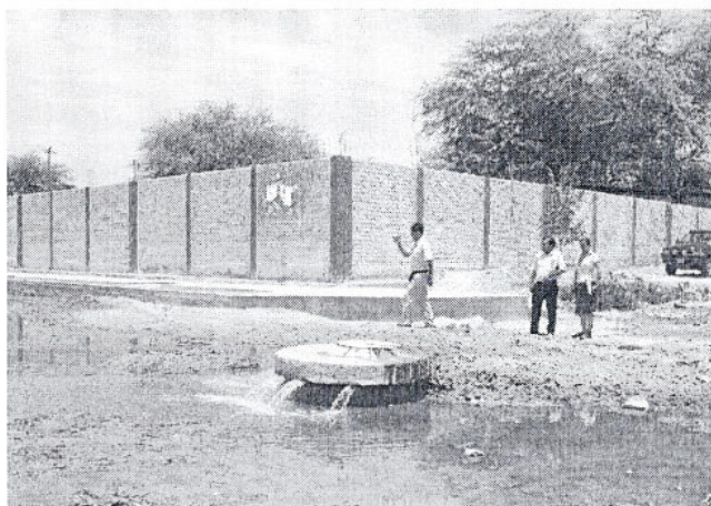
Colector colapsado en el Jr. M, a espaldas del Centro de Salud.
