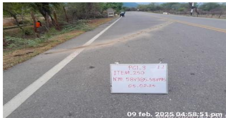
Situación Después Fisuras (LI)
