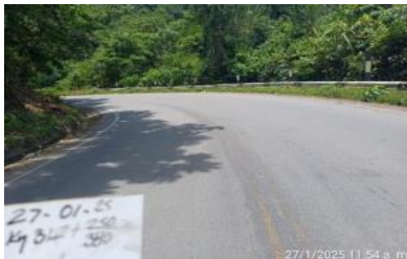
Decoloración señalización horizontal km 338+471 (antes)
