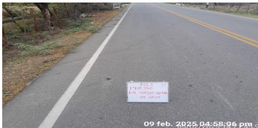
Situación Antes Fisuras (LI)
