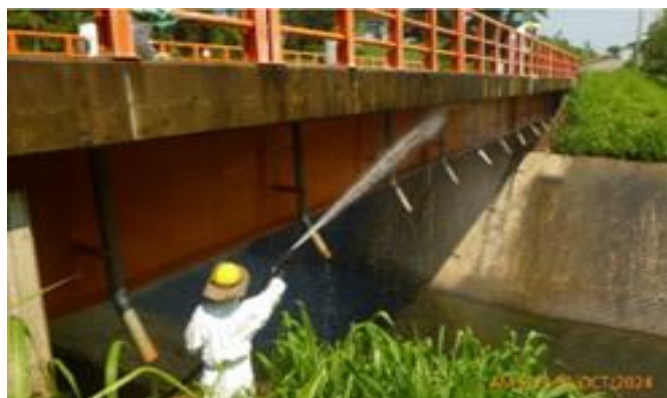
Suciedad en elementos metálicos puente Loboyoc km 450+850 (antes)
