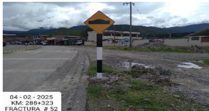
Deterioro señal vertical km 288+323 (después)
