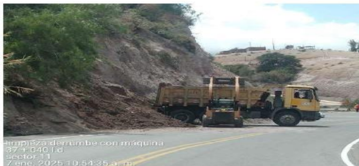
Sector: 11 Descripción: Limpieza de derrumbe con equipo Progresiva: 37+040
