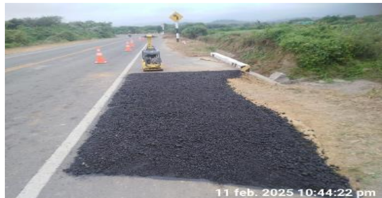
Situación Después Hundimiento (LI)
