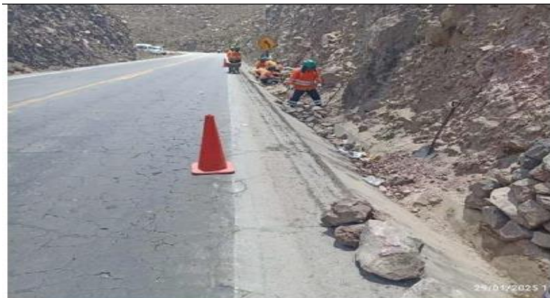
Sector : 04 Descripción : Obstrucción Hidráulica Progresiva : 64+600 LD.
