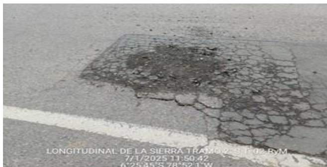
Parche en mal estado km 17+910: Cutervo-Cochabamba (antes)
