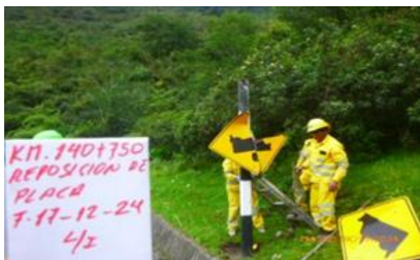
Deterioro del mensaje de las placas de señales km 140+750 (antes)
