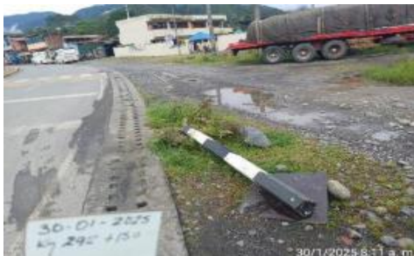
Deterioro señal vertical km 288+323 (antes)
