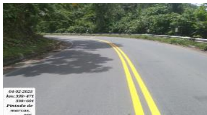
Decoloración señalización horizontal km 338+471 (después)
