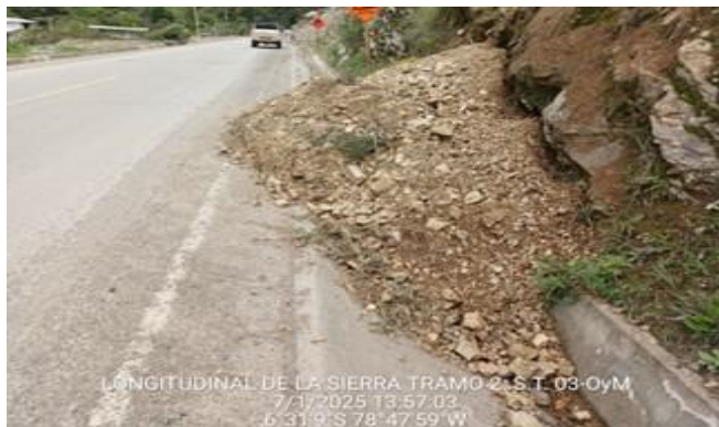
Cuneta obstruida km 132+090: Cochabamba-Chota (antes)
