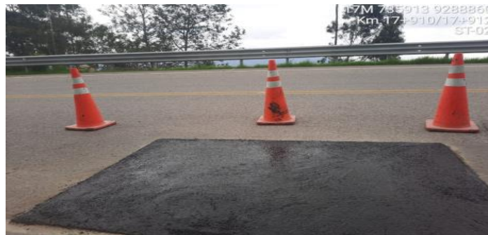
Parche en mal estado km 17+910: Cutervo-Cochabamba (después)
