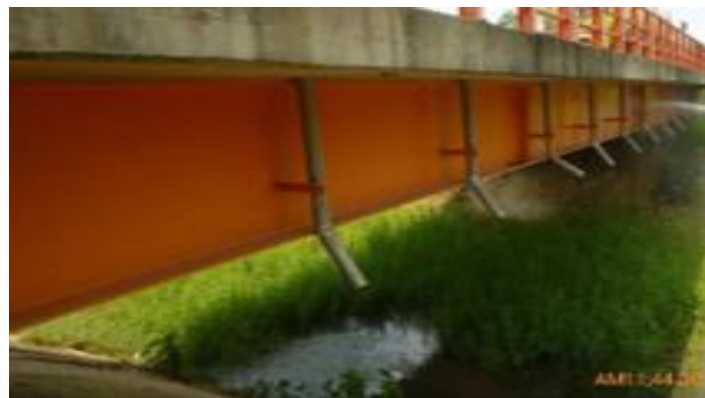
Suciedad en elementos metálicos puente Loboyoc km 450+850 (después)
