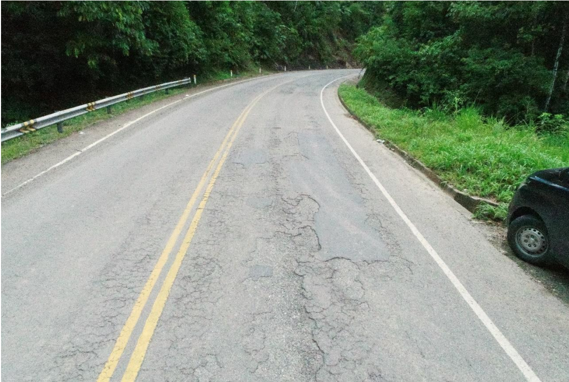
Antes – Pavimento deteriorado
