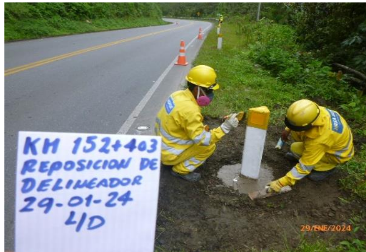
Deterioro delineador (cinta reflectiva)
