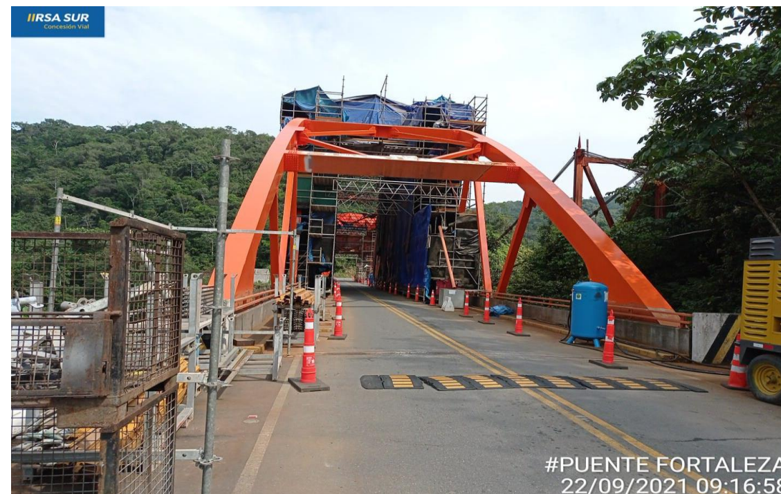
Después – Intervención de la pintura (ITM)
