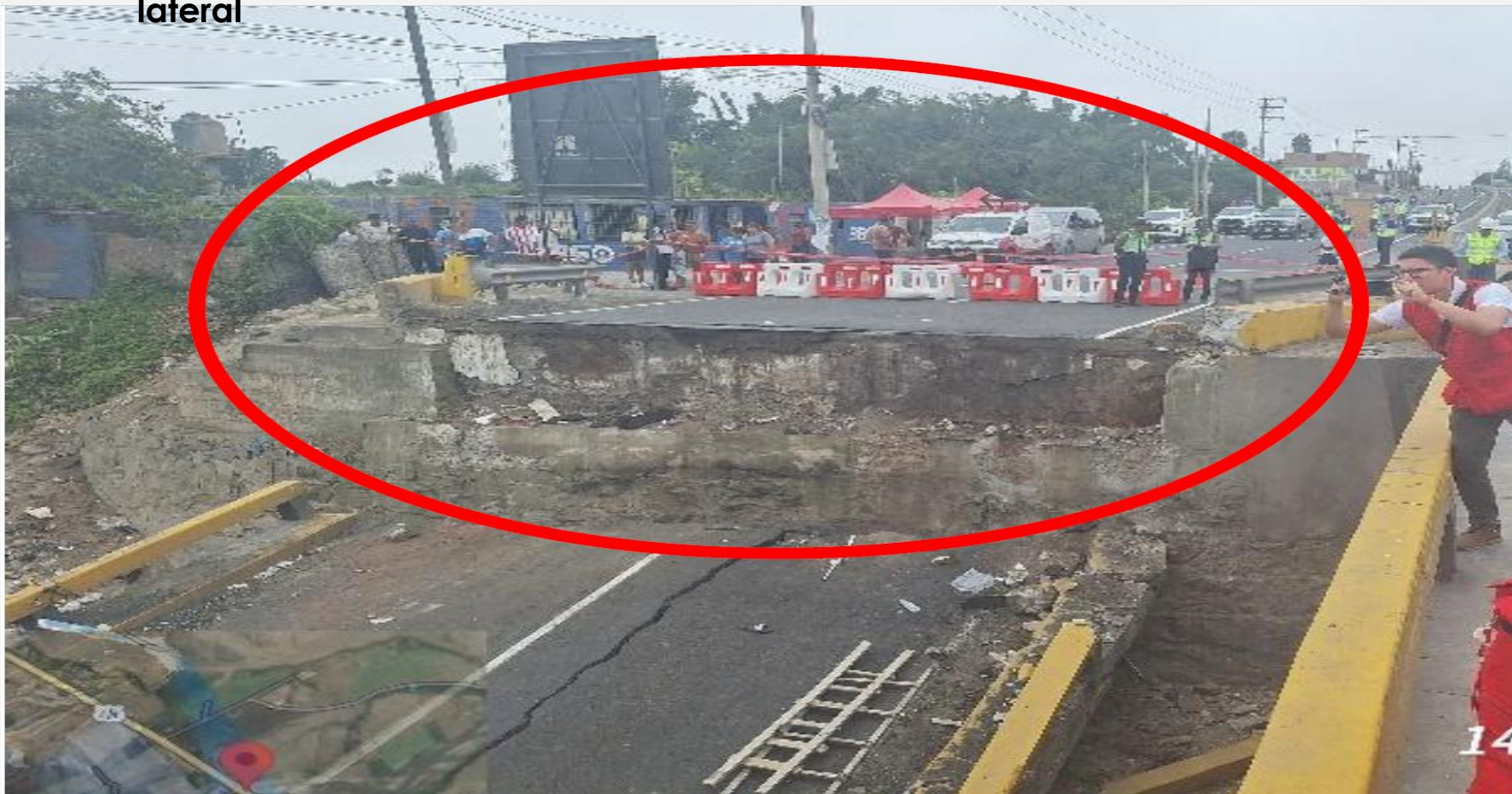
Imagen N° 3: Tablero del Puente “Chancay” fracturado y desprendido del estribo lateral
