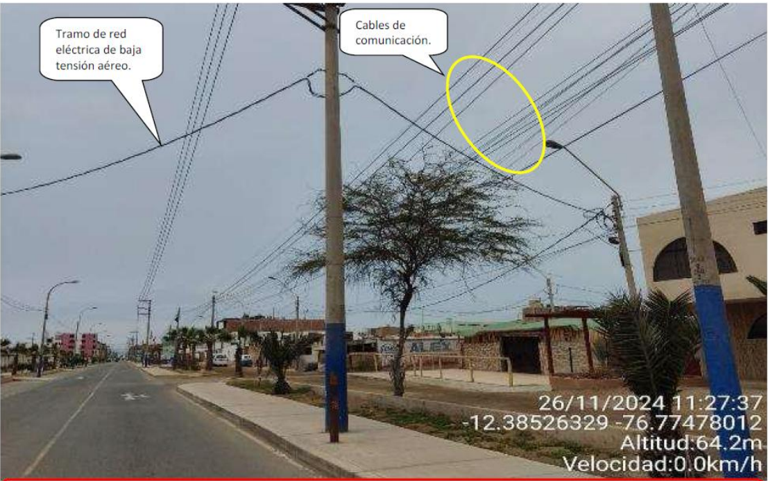
Foto 63. Se observa tramos de red eléctrica de baja tensión aéreos y el resto corresponden a cables de comunicación en la Av. San Bartolo, San Bartolo, coordenada: -12.38526329; -76.77478012.
