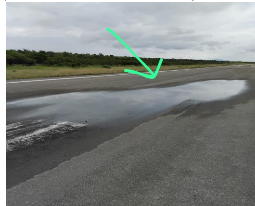
El 25 de marzo 2025, observación de la Contraloría, zonas de la pista no incluidas en el mantenimiento, presentan bacheo donde se acumula agua.
