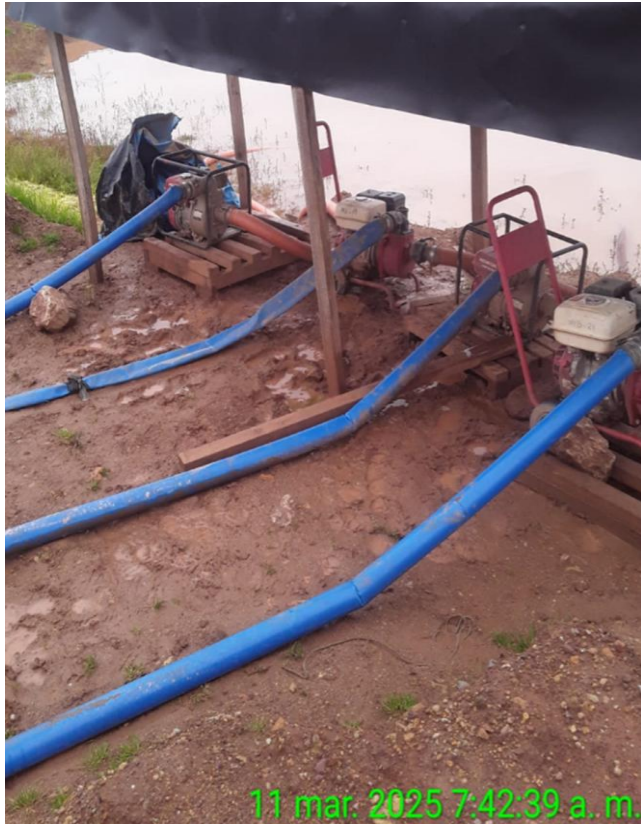
Activación y Bombeo de aguas pluviales hacia el Dren Norte.
