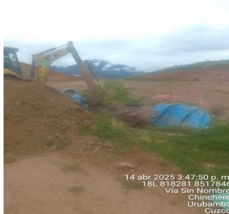
Adecuado Manejo de aguas pluviales
