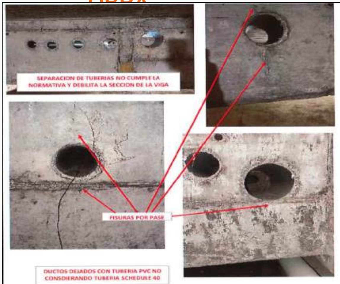
FISURAS EN VIGAS DE AISLAMIENTO Y PERIMETRALES
