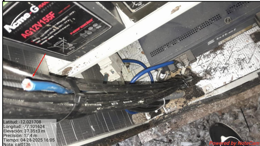
Cable de cobre de baterías vandalizado Nodo Principal
