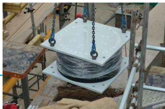
AISLADORES SÍSMICOS 1104 INSTALADOS
