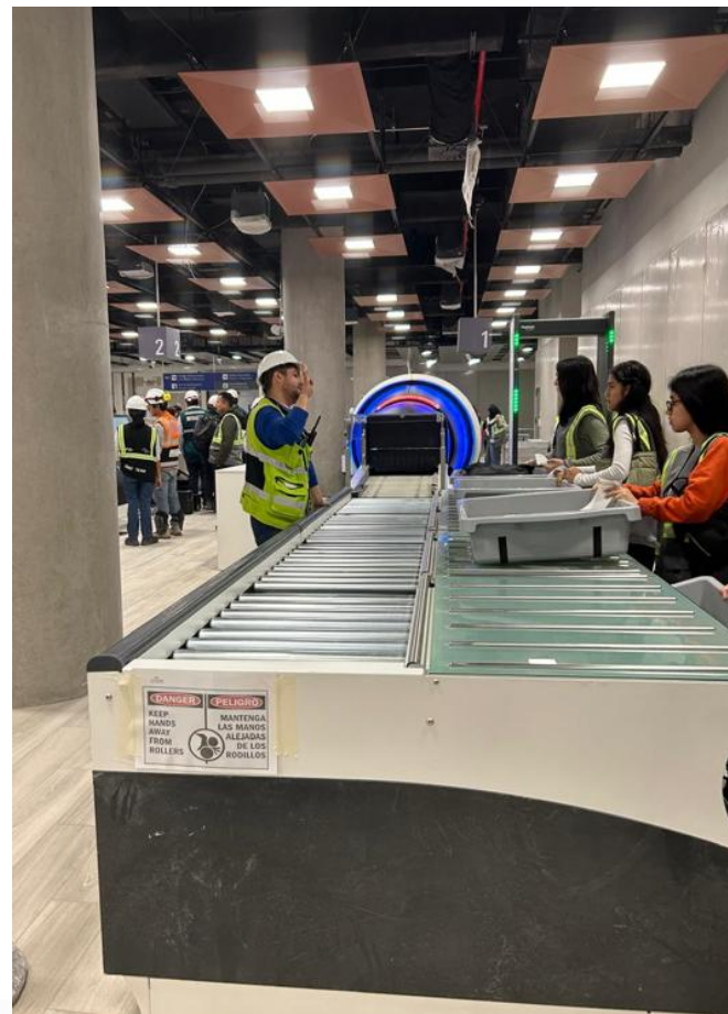
Los equipos probados son operados por personal técnico, NO POR PERSONAL DE SEGURIDAD como será en la operación normal.
