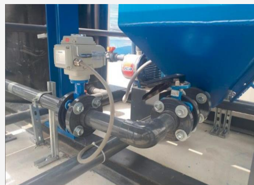
SISTEMAS DE TRATAMIENTO DE AGUA
