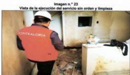
Fuente: Visita de Inspección del Servicio, de 3 de noviembre de 2023.
