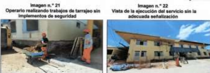
Fuente: Visita de Inspección del Servicio, de 3 de noviembre de 2023.
