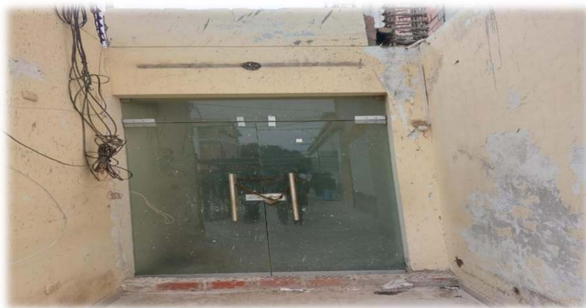
TORRE ONCOLÓGICA ESTADO DE ABANDONO
