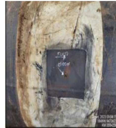
Fotografía 2. Perforación 01 pasante obturado con madera
