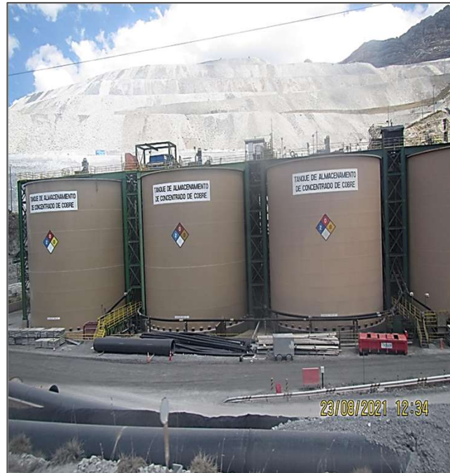
Vista panorámica de los Tanques de almacenamiento y recepción de concentrado, adyacente a la planta concentradora
