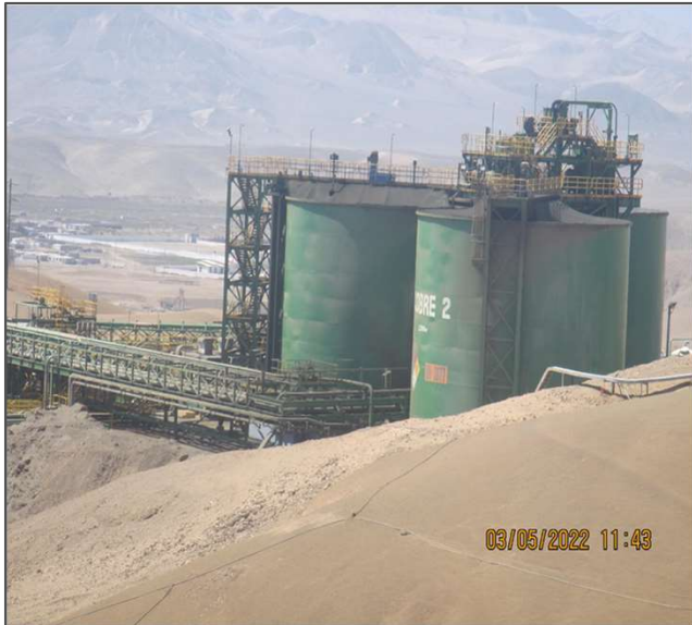
Vista panorámica de los espesadores de pulpa de concentrado
