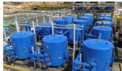
COLUMNAS DE ADSORCIÓN
