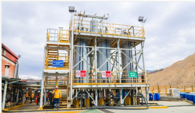
COLUMNAS DE DESORCIÓN
