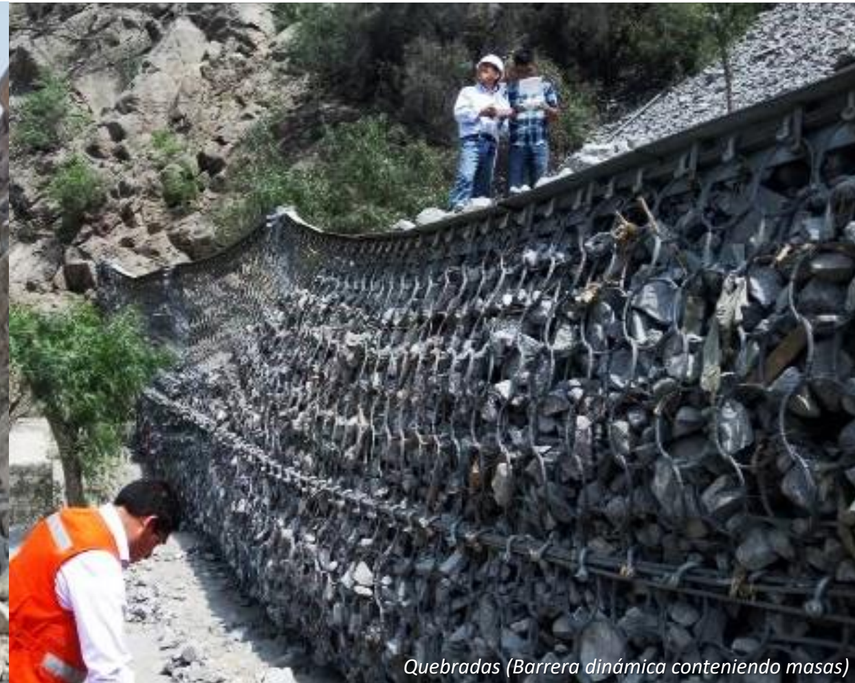
Quebradas (Barreras dinámicas)
