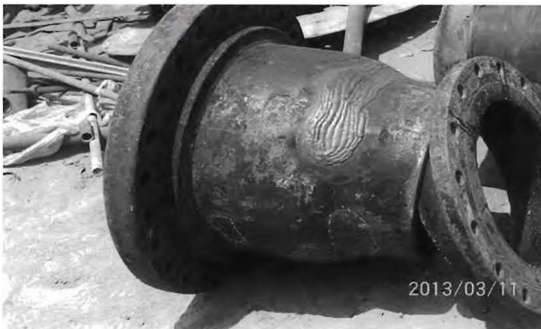
Figura 10. Evidencia una soldadura del PLEM en el 2013
