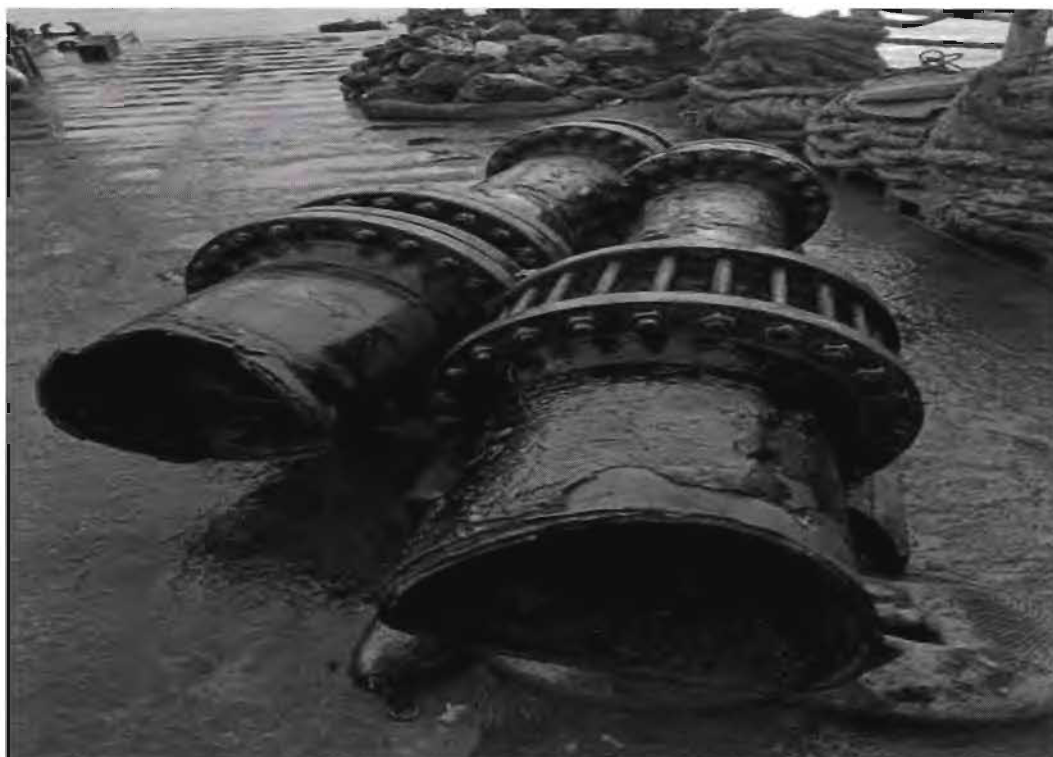
Figura 21. Los Ramales Norte y Sur desprendidos del PLEM
