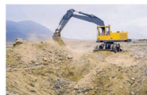
TERRENOS DEL ESTADO. Con maquinaria pesada y 90 policías desalojaron a mafiosos de tierras.
