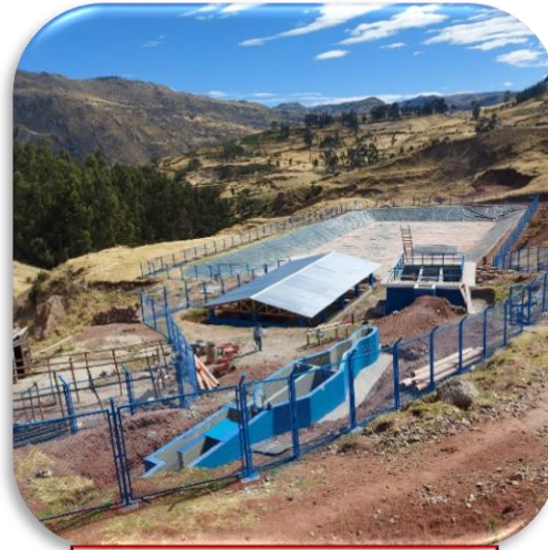
PLANTA DE TRATAMIENTO DE AGUAS RESIDUALES - PTAR
