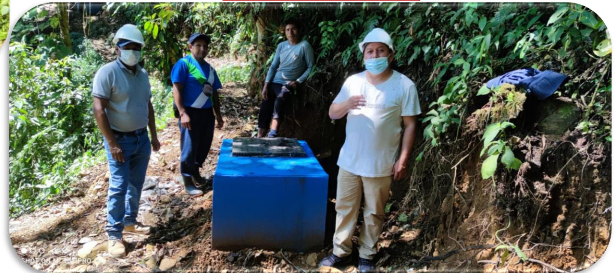
CÁMARA ROMPE PRESIÓN
