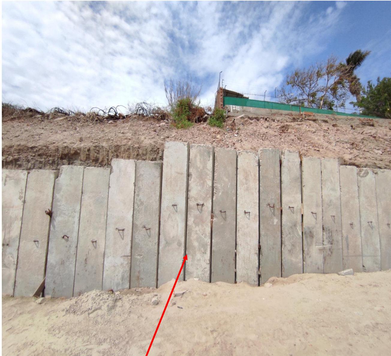
ESPACIAMIENTO EXCESIVO ENTRE TABLAESTACAS HINCADAS POR EL PRIMER CONTRATISTA, PROBABLE ZONA DE FILTRACION DE FINOS.
