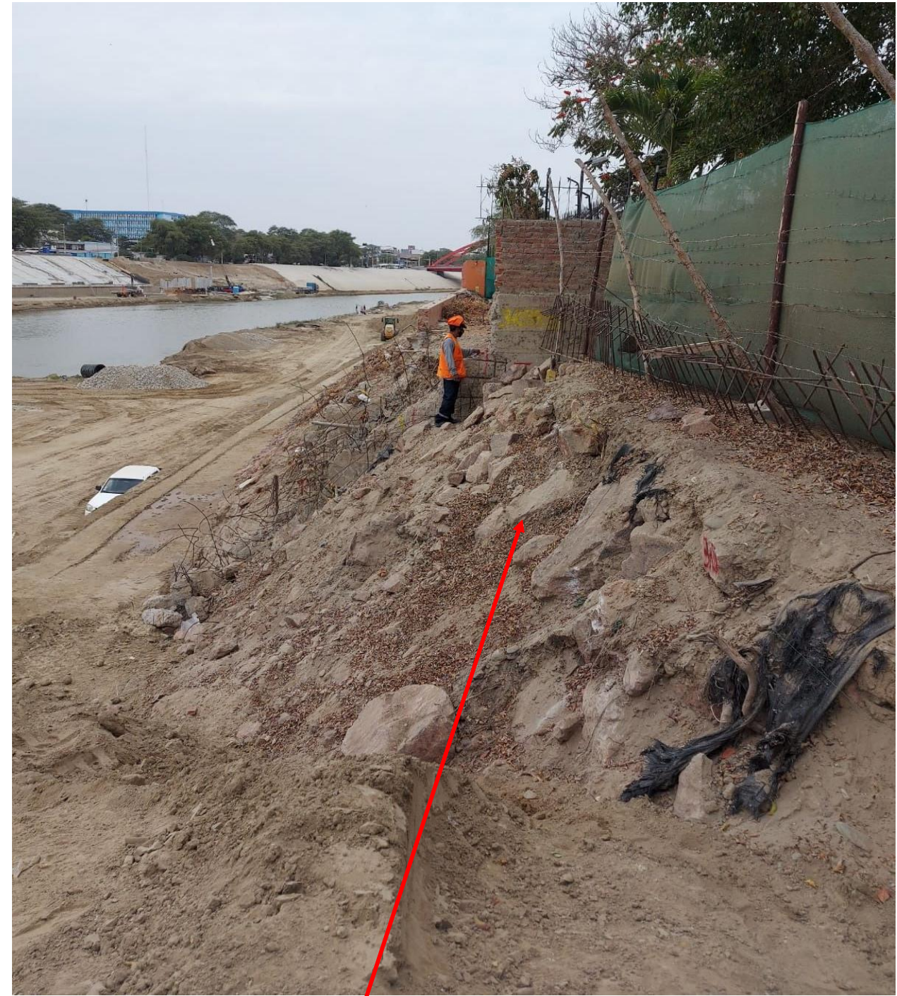
ENROCADO (TIPO FILTRO) COLOCADO POR PROPIETARIO DE CASA CONTIGUA.
