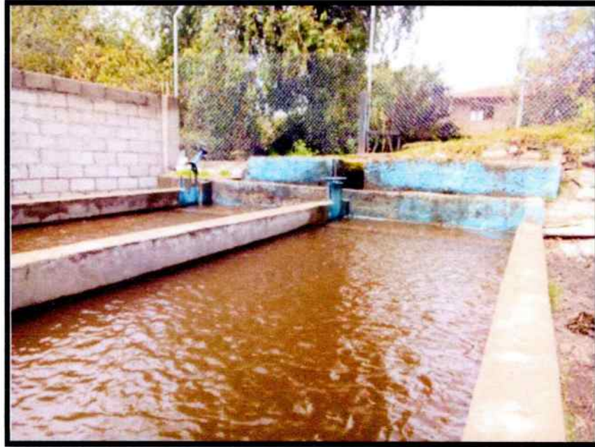
Figura N° 02, Evidencia la elevada turbiedad en la captacion.
