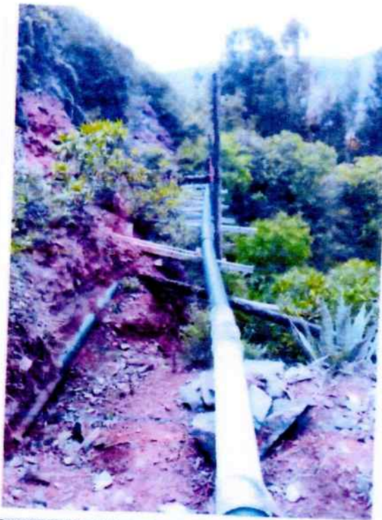
Fotografía N° 3. Línea de conducción el sector de Ccatan, los tubos están en la intemperie.
