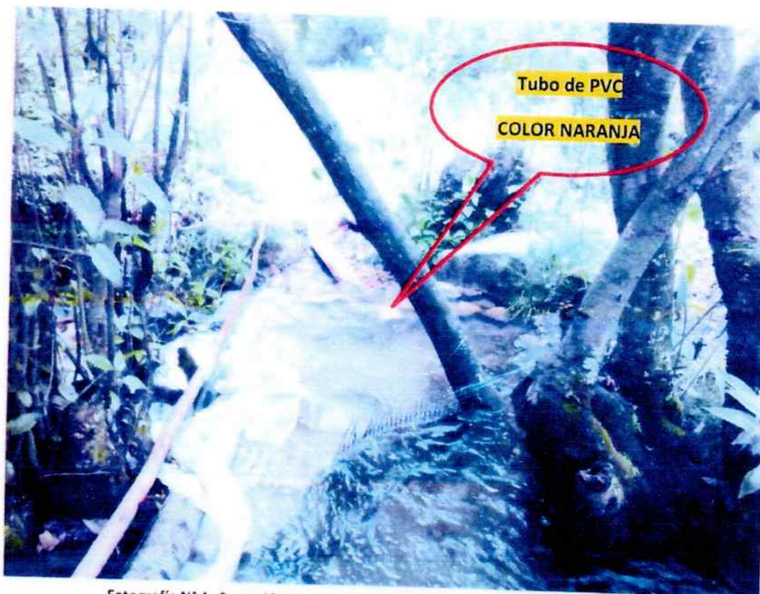
Fotografía N° 1. Captación Pumahuanca, se evidencia lo precario y vulnerable.
