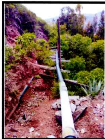
Figura N° 03, Evidencia la tubería en la interperie, sujetado con un castillo de palos rollizos.
