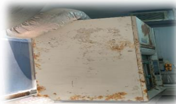
Azotea - contenedores con sustancias cancerígenas.
