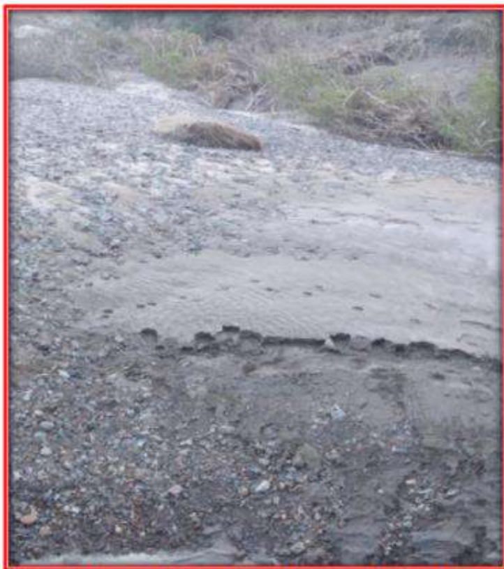
Colmatación del Canal revestido cojal
