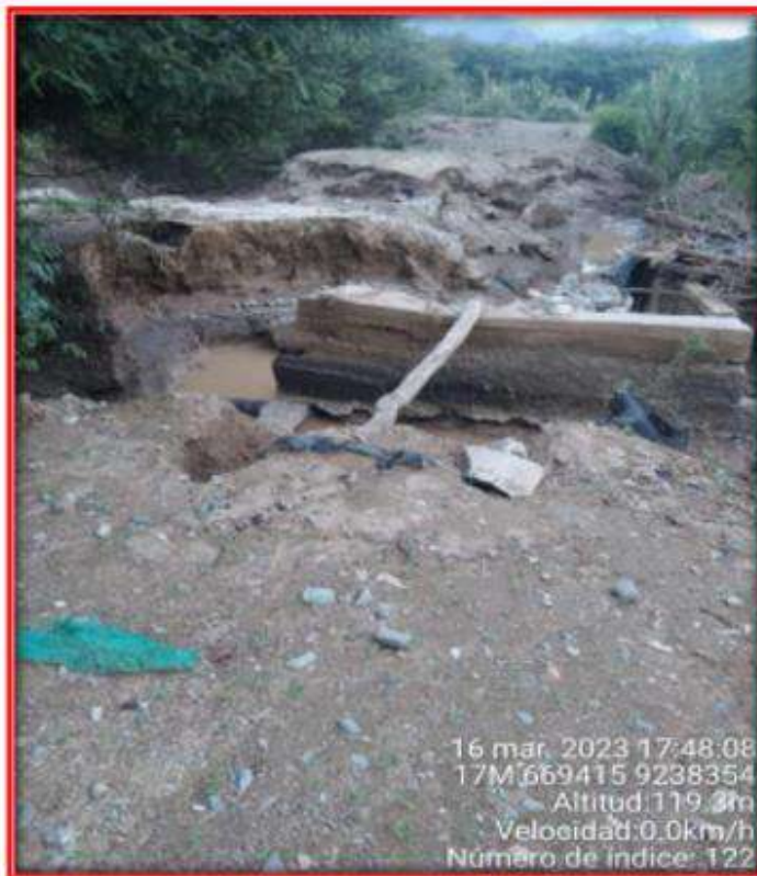
Colapso del aliviadero en canal Cojal
