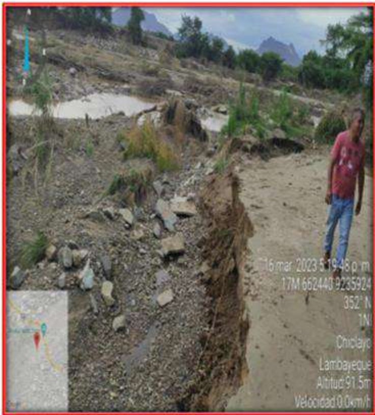
Colapso de la estructura de captación
