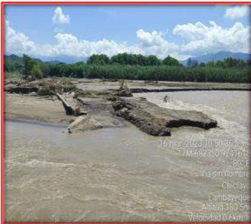
Tramo colapsado UTM 682350 - 9241615
