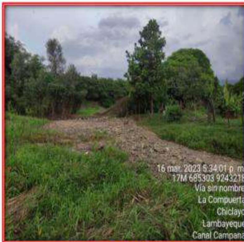
Tramo colmatado UTM 685303 - 9243218
