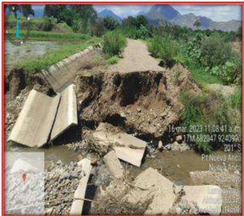
Tramo colapsado UTM 682047 -9240990
