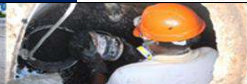
Sedimentación y Atoros de Cámaras de Desague
