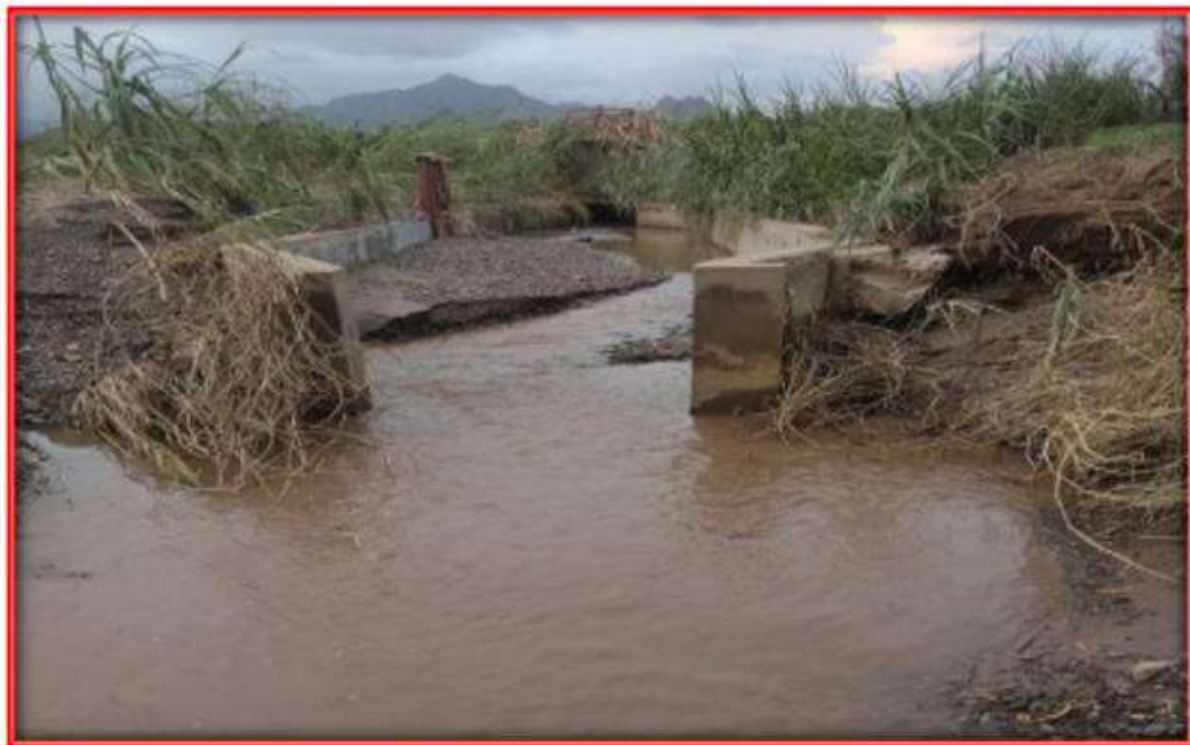
Colapso del desarenador de la toma
