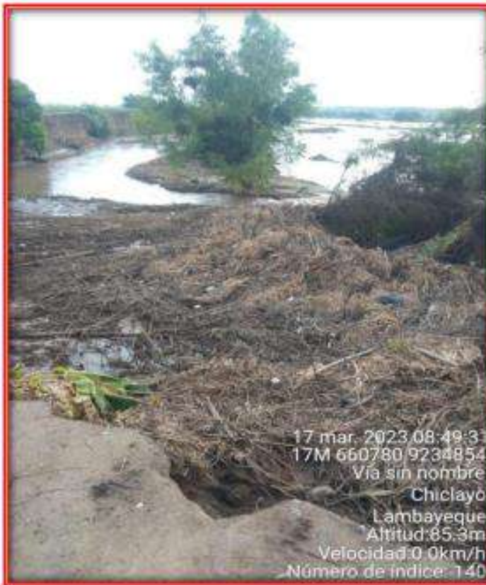
Captación y canal revestido colmatado
