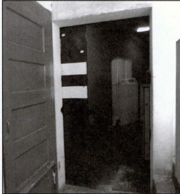
Imagen n.º 2 Exterior del ambiente de la Central Generadora de Gases Medicinales, ni señalización
