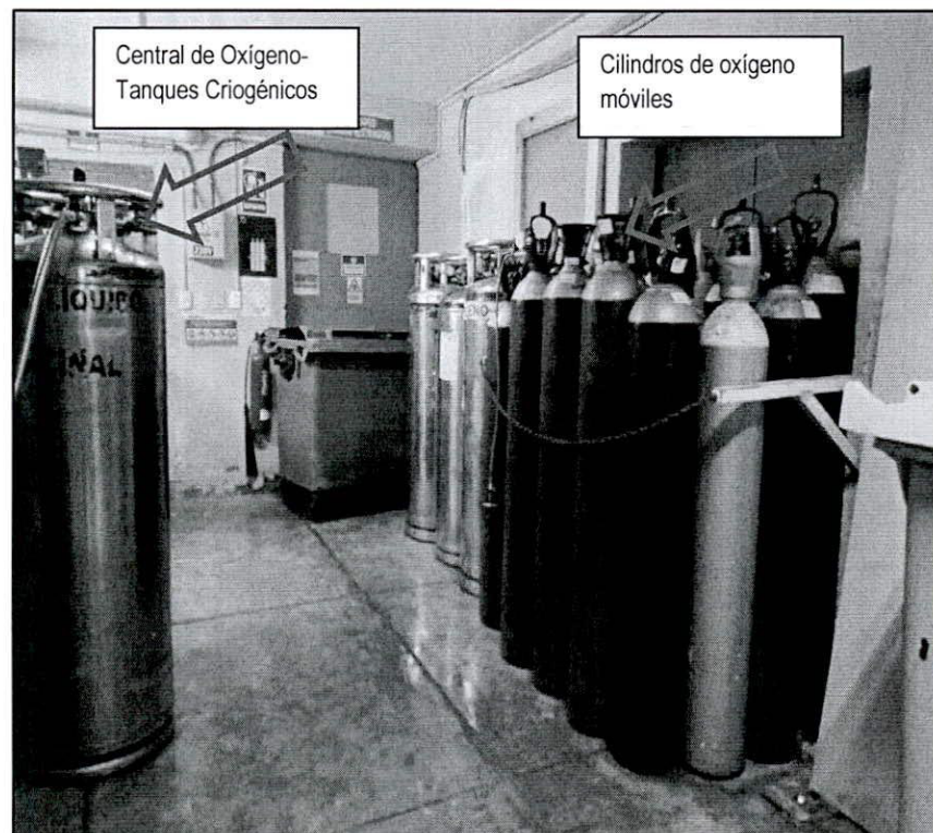
Imagen n.º 1: Central de Oxígeno Tanques Criogénicos y Almacenaje de Cilindros Móviles
