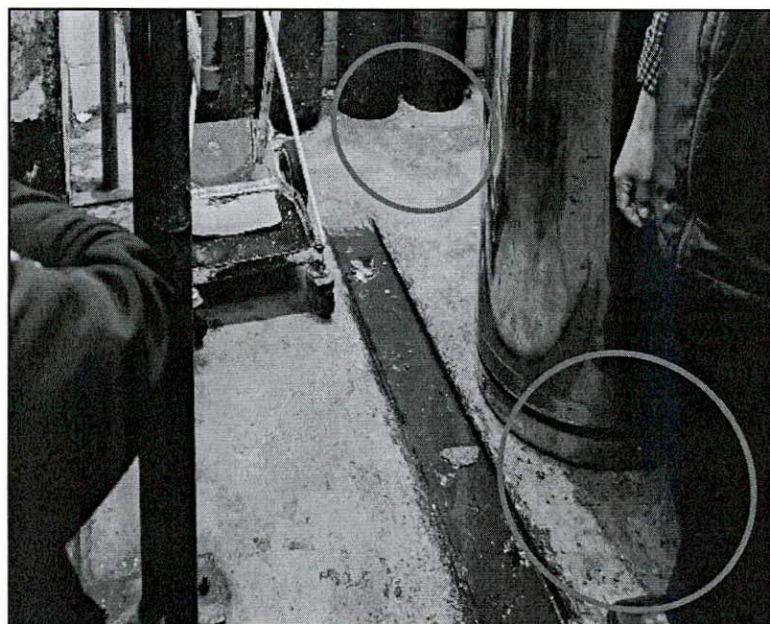
Imagen n.º 3: Piso húmedo en ambiente de tanques de oxígeno
