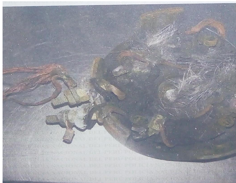
Parte del motor eléctrico del sistema de Aire Acondicionado.
