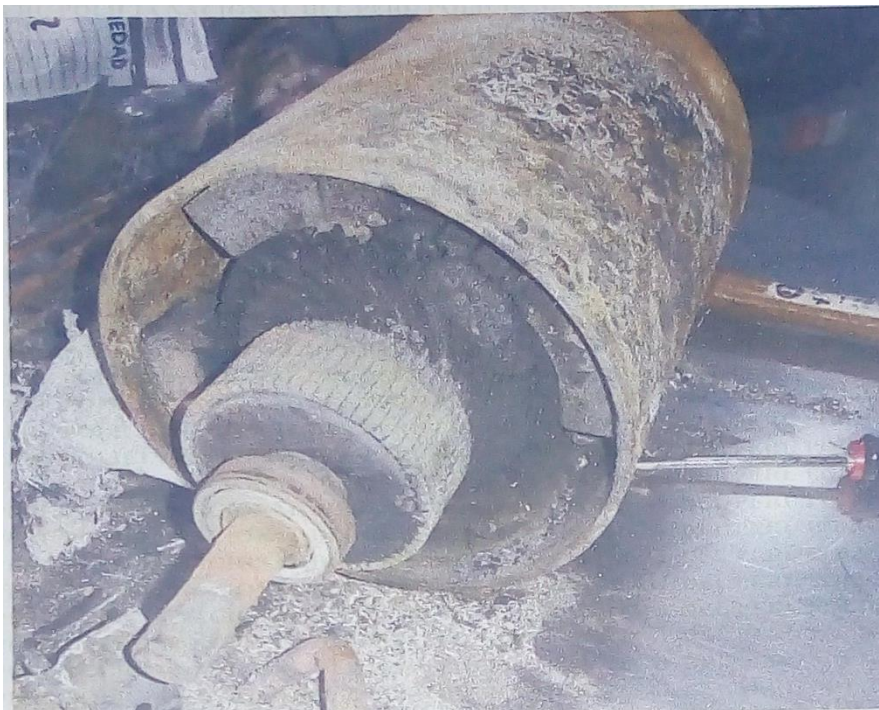
Motor eléctrico del sistema de sistema de Aire Acondicionado.
