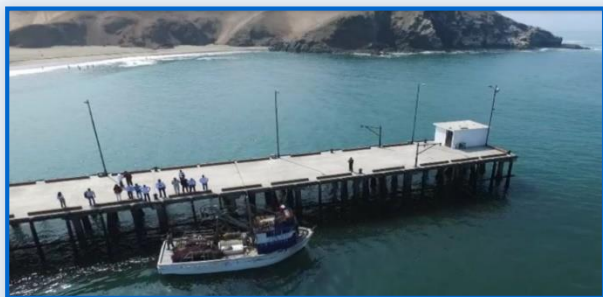
Fig. N°01 La embarcación pesquera artesanal no logra acoderar en el lado norte del muelle por el peligro de romperse al golpear el sistema de defensas tipo D ( Lado Norte ).
