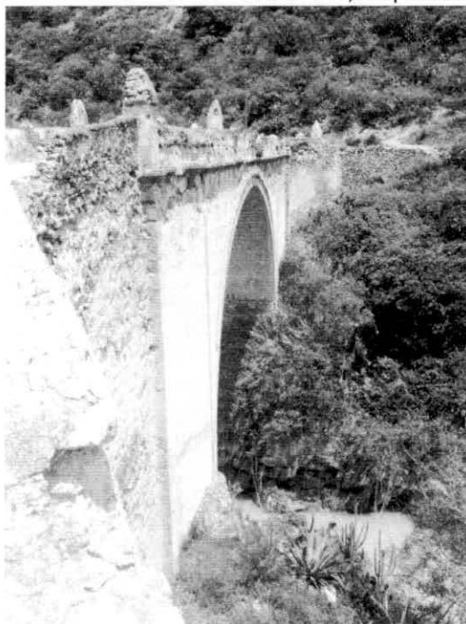
Foto: Vista, estructura del Puente Pachachaca, en proceso de deterioro
