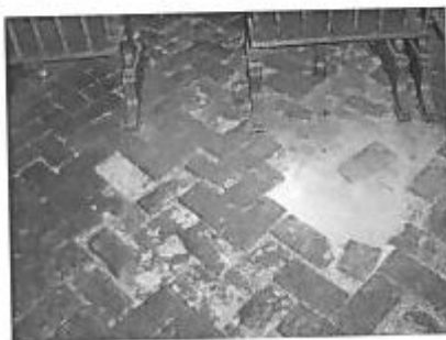
Piso de Sala de Audiencias altamente dañado. Piezas de 20x10cm
