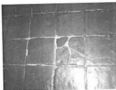
Piso de Cuarto del Secreto algunas piezas dañadas de 25x25cm.
