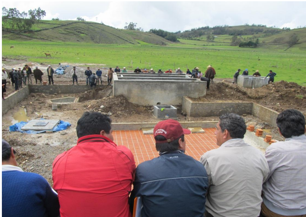
Inspección de la planta de tratamiento con los pobladores de la comunidad del distrito de La Libertad de Pallán, donde se encontró fallas de construcción como deslizamiento, hundimiento de base y rajaduras.
