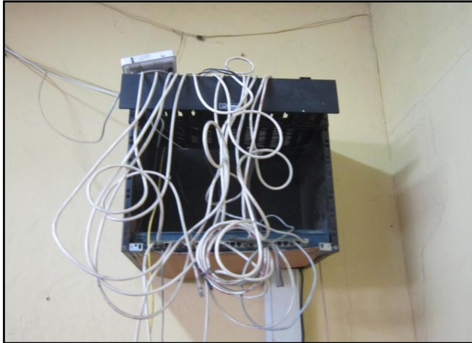
CABLEADO CON INSTALACION INADEACUDO
