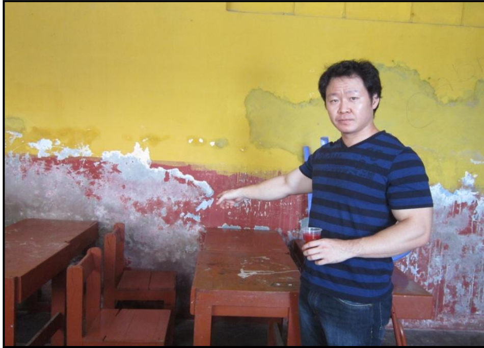
PROBLEMAS DE FILTRACIONES EN LAS AULAS
