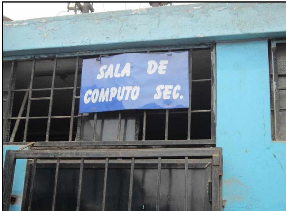
SALA DE COMPUTO SIN LUNAS NI SEGURIDAD APROPIADA, AMBIENTE INADECUADO
