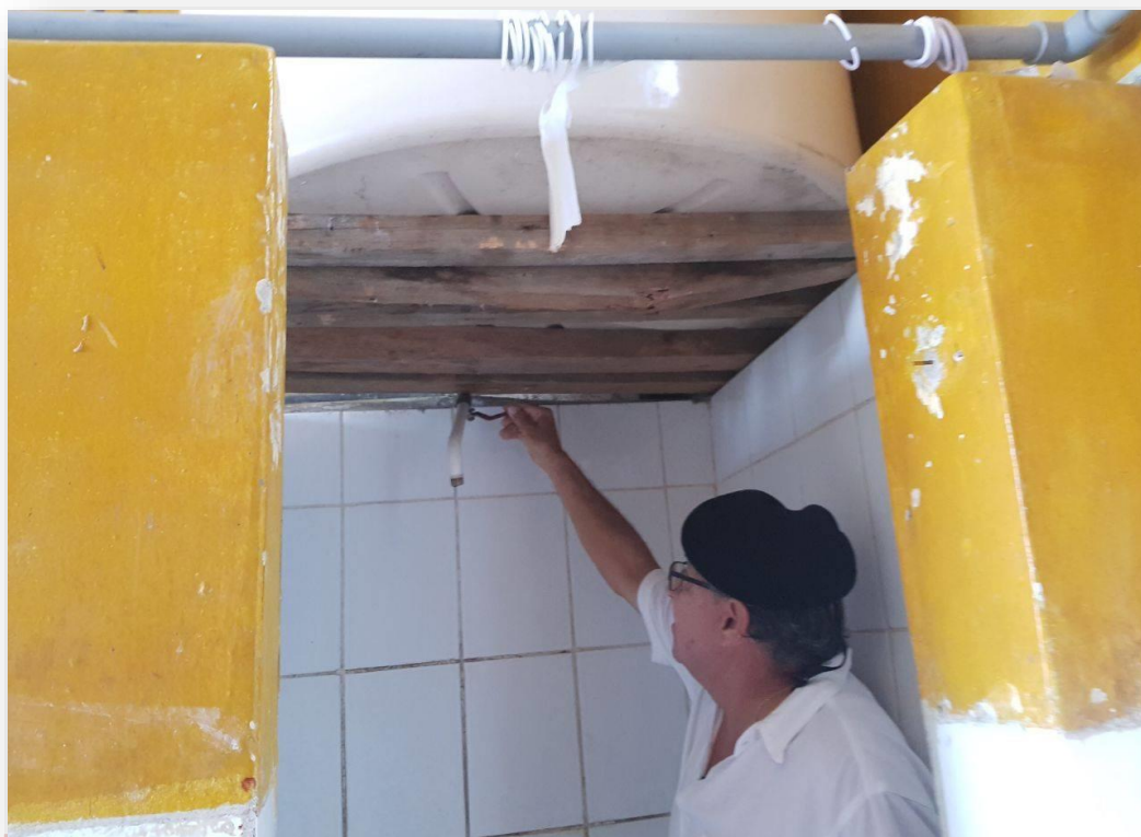
Daños - instalaciones sanitarias del Cuartel "General Coloma"
