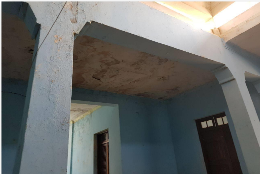
Filtraciones en techos y paredes del Cuartel "General Coloma"
