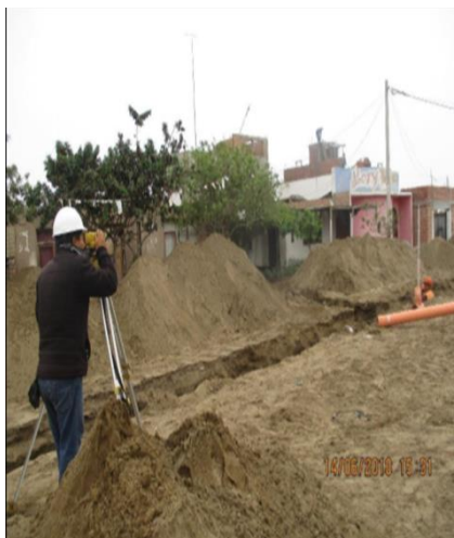
Topógrafo realizando la plantilla para la instalación de tubería de alcantarillado en el Pasaje Miguel Grau
